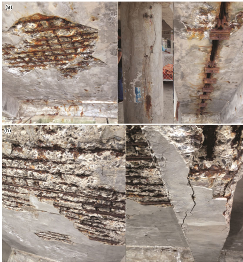
图6 某景区东北和西北承重柱、顶板的锈蚀情况
