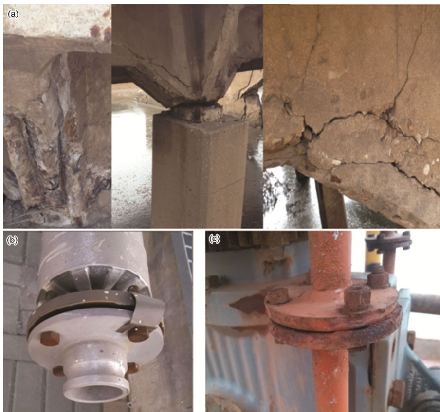
图4 港口码头的腐蚀情况
