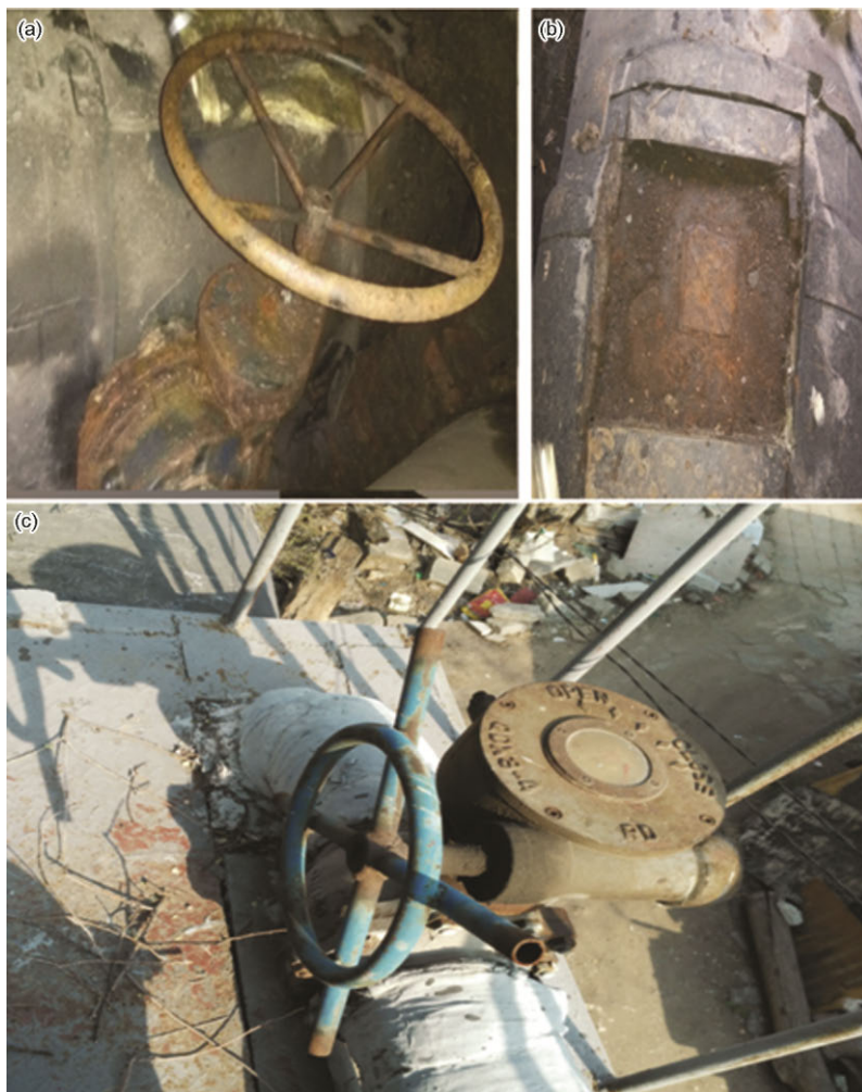
图5 烟台某供热公司地下管线运行3和8 a,地上管线运行10 a的锈蚀情况
