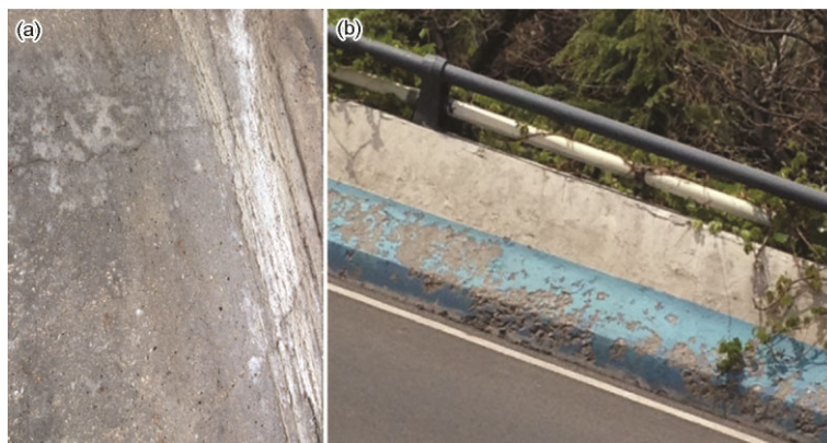
图3 ZFD立交桥桥台和护栏上的蜂窝
